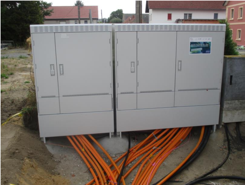
Bild: Hauptverteiler in Großenhain OT Folbern
